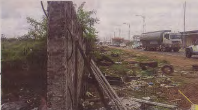
La barrière de protection de la décharge publique doit être rénovée.
