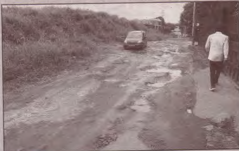
Une vue de l'état des routes.
