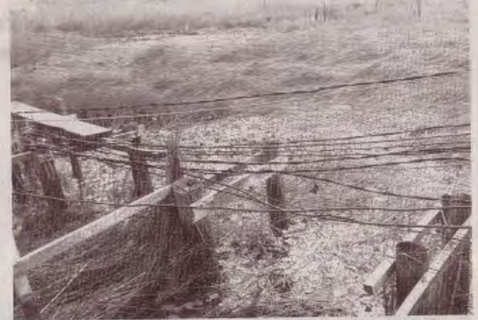
Des câbles électriques disposés de façon anarchique aux abords des passerelles sont la cause de plusieurs décès par électrocution.
